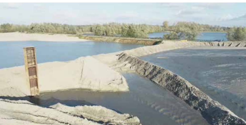
Das gewonnene Material wird auf Spülfelder aufgepoldert und anschließend mittels Radlader dem Rohkies beigemischt.
