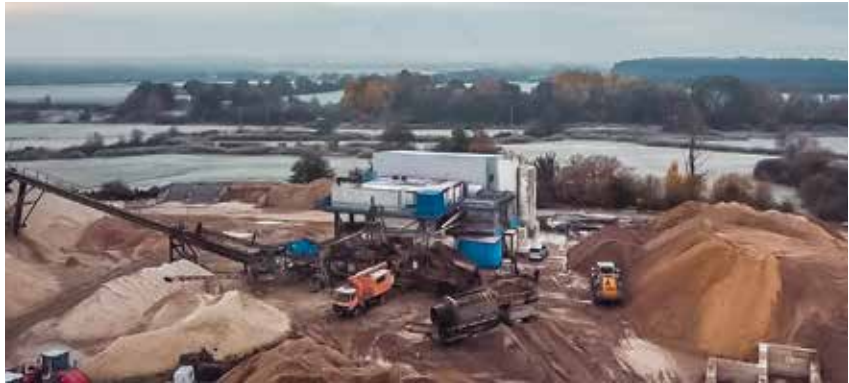
Das Unternehmen hat eine Sandwaschanlage mit Schlammentwässerung zur Waschwasserrückgewinnung individuell entwickelt.
